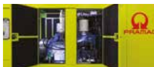
Большие двери для удобства осмотра и обслуживания
